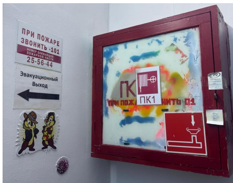
Пожарный шкаф на 1 этаже
