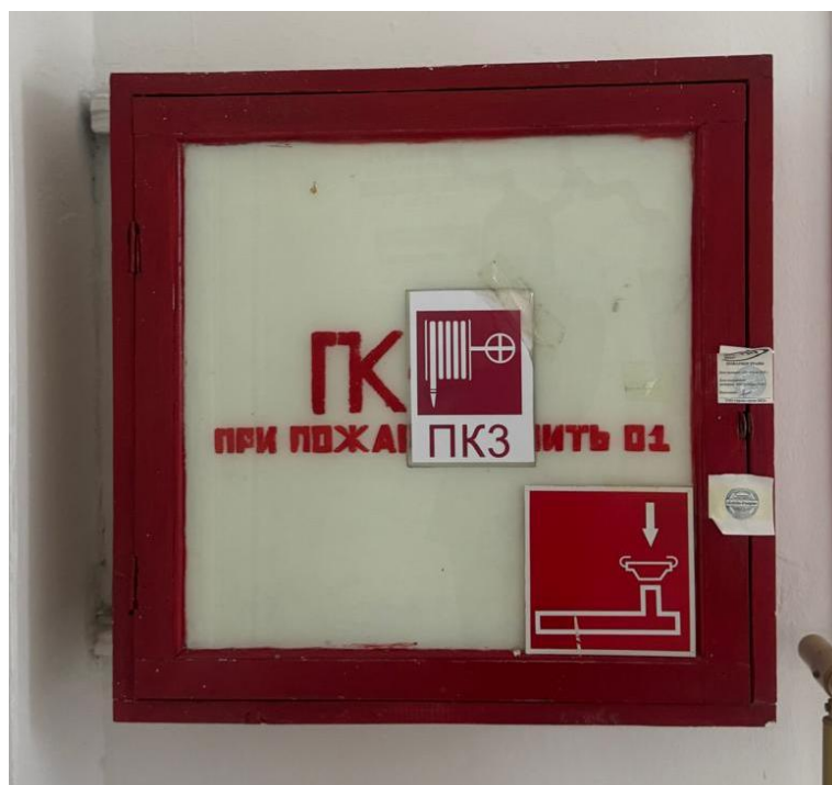
Пожарный шкаф на 3 этаже
