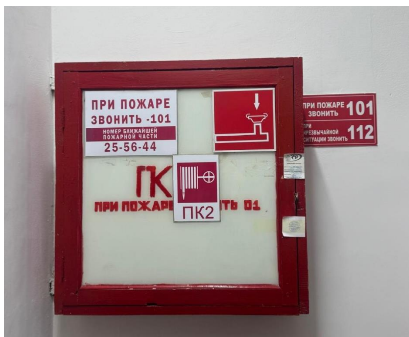
Пожарный шкаф на 2 этаже
